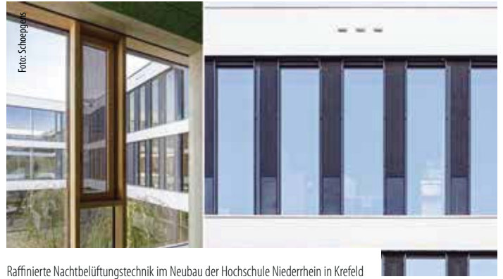
Raffinierte Nachtbelüftungstechnik im Neubau der Hochschule Niederrhein in Krefeld
